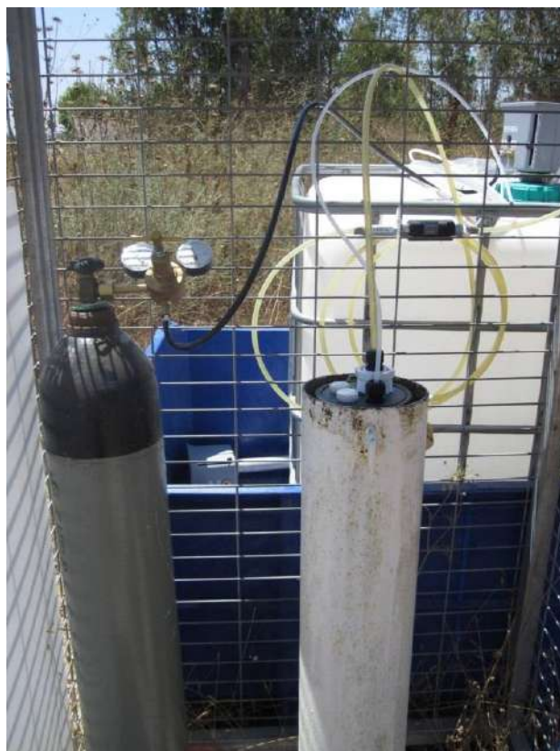
איור 11: מערכת סקימר אקטיבי לשאיבת דלק בבסיס חצור
